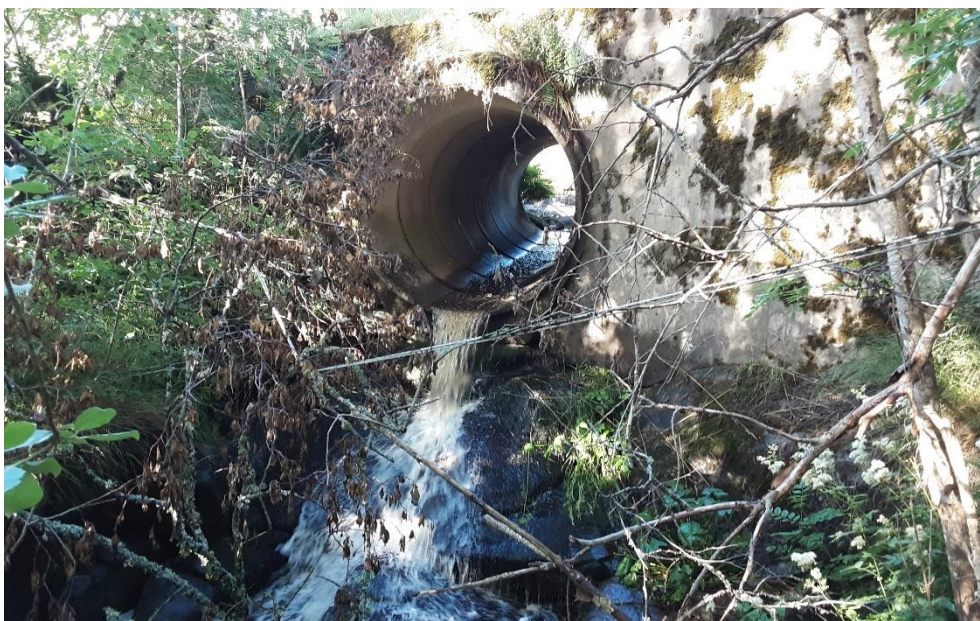
Figur 34. Vägtrumma som klassades som definitivt vandringshinder för alla fiskar på grund av den fria änden samt att det inte finns en pool nedströms för hoppande fisk att ta sats i.
