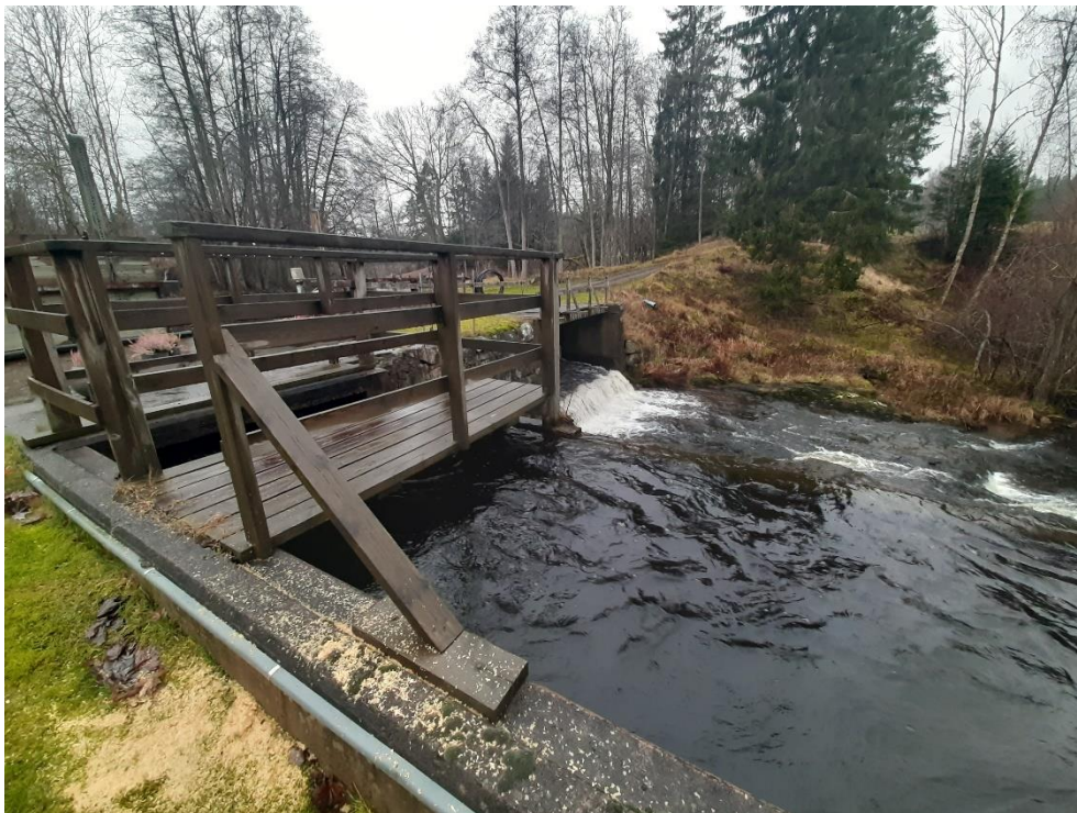
Figur 23. Jädersfors kraftverk i Risån.
